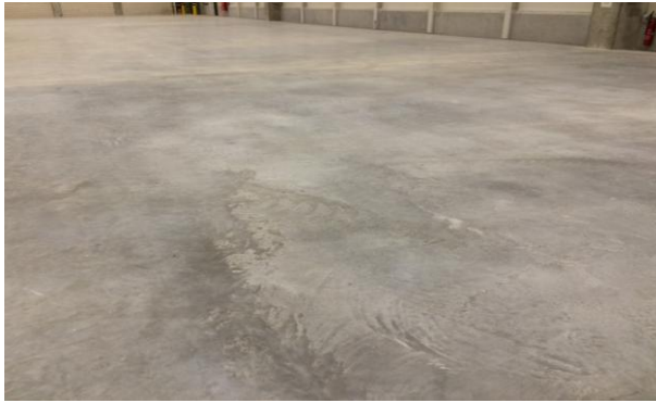
Fotografia 13. Przebarwienie – blizna na powierzchni posadzki.
