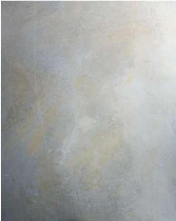
Fotografia 11-1. Przykład przebarwień o rdzawo-żółtawym odcieniu.
