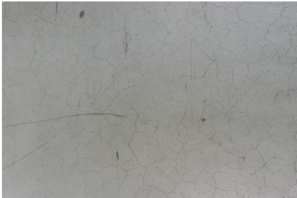
Fotografia 8. Mikrospeknięcia na powierzchni posadzki .
