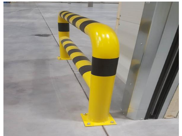
Fotografia nr 1. Osadzenie odbojników powodujące zszycie pól posadzki.
