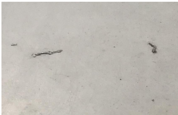
Fotografia 15. Włókna stalowe na powierzchni posadzki
