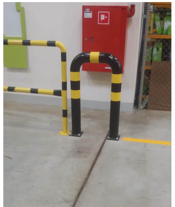
Fotografia nr 2. Osadzenie odbojników powodujące zszycie pól posadzki.
