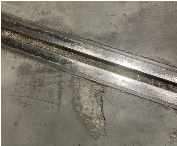
Fotografia 11-2. Przykład uszkodzeń posadzki w rejonie szyn regałowych szynowych.
