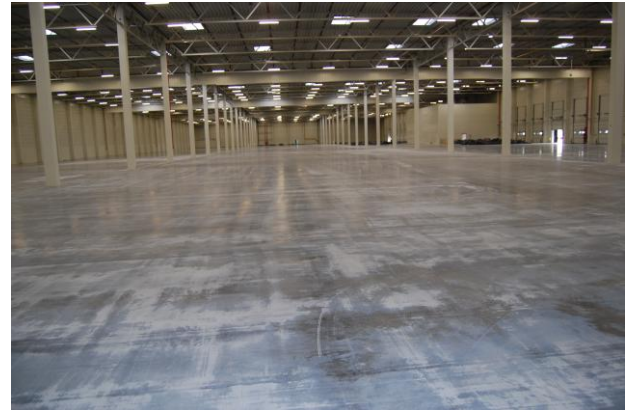
Fotografia 5. Wykwyty solne posadzki w okresie jej dojrzewania przed rozpoczęciem eksploatacji.
