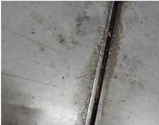
Fotografia 18. Przykład uszkodzeń mechanicznych posadzki – zarysowania i wykruszenia posadzki w rejonie dylatacji wynikające z transportu bez prawidłowego uniesienia widła/ładunku.
