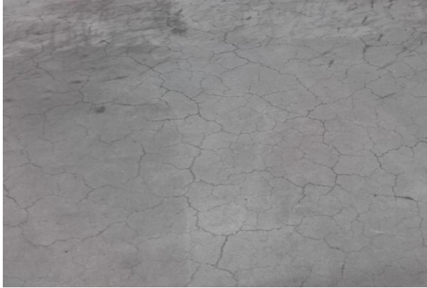
Fotografia 7. Mikrospeknięcia na powierzchni posadzki
