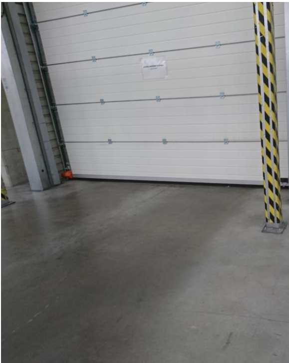
Fotografia 11. Lokalne wytarcie posadzki w bramie wjazdowej.
